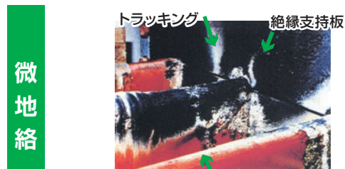
スイッチギヤでのトラッキングによる火災(例)
